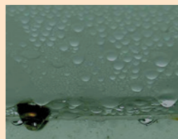
取り付け前結露の様子
