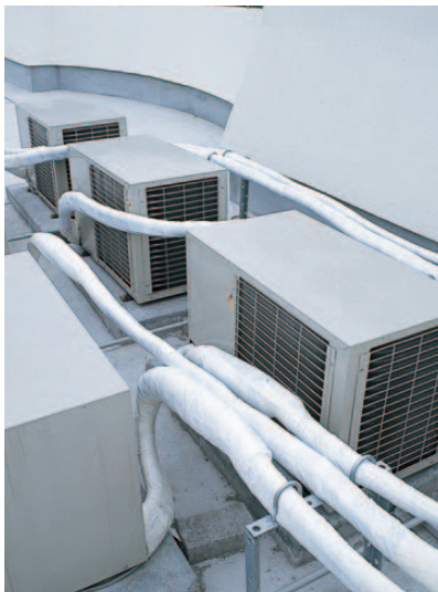
業務用エアコン断熱配管
